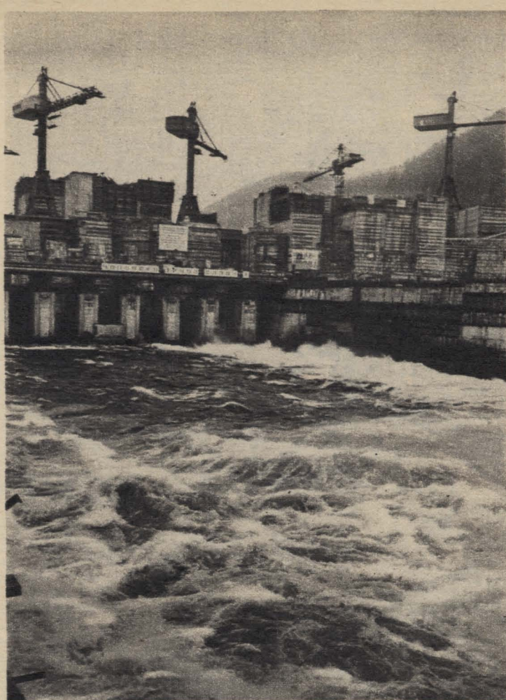
Саяно-Шушенская ГЭС готовится дать первый ток.
